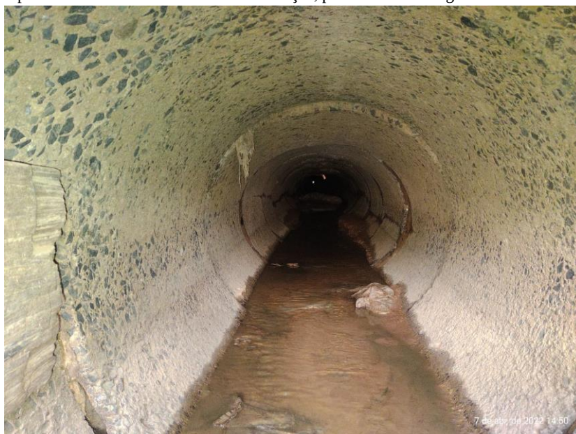
Rede tubular comprometida
