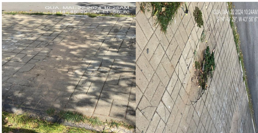
Imagem 10 – Piso de Concreto a Recuperar
