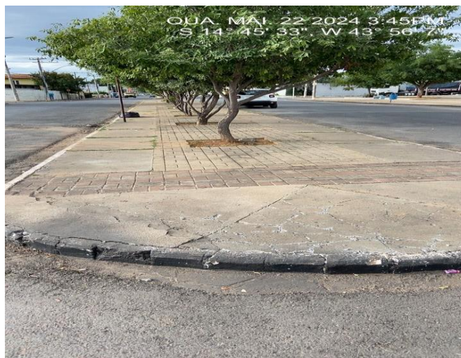
Imagem 9 – Piso de Concreto a Recuperar
