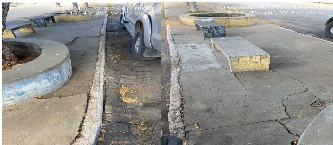
Imagem 8 – Piso a ser Recuperado, 7,5m x 2,5m neste local
