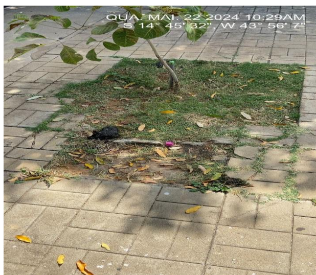
Imagem 11 – Piso de Concreto a Recuperar
